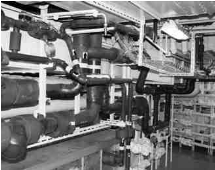
Impianto HVAC – Interno AC station: tubazioni acqua refrigerata e calda
