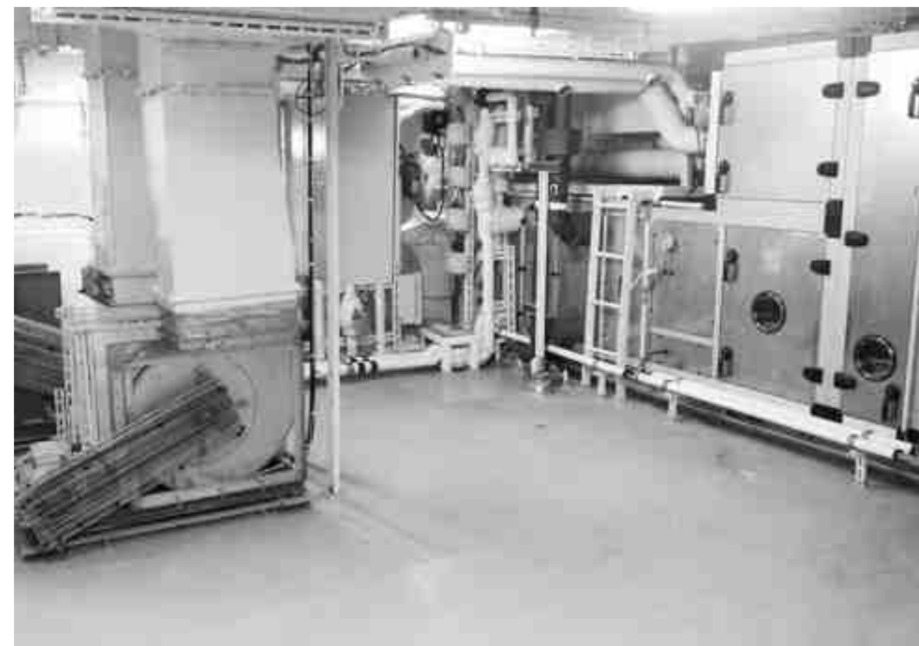
Impianto HVAC – AC station in servizio
