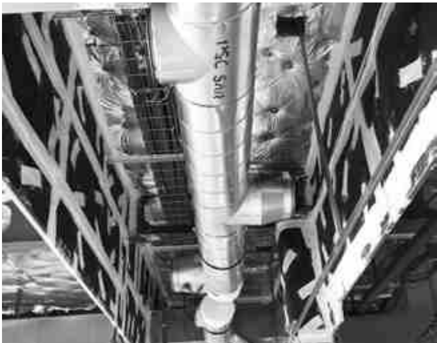
Impianto HVAC – Plenum area pubblica
