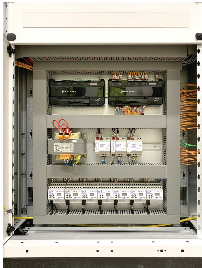
■ Sistema BMS: Controller e moduli di acquisizione IN/OUT
