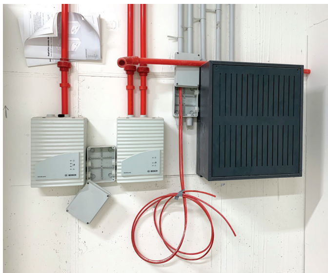
■ Centrali e tubazioni dell'impianto di aspirazione fumi con campionamento dell'aria
