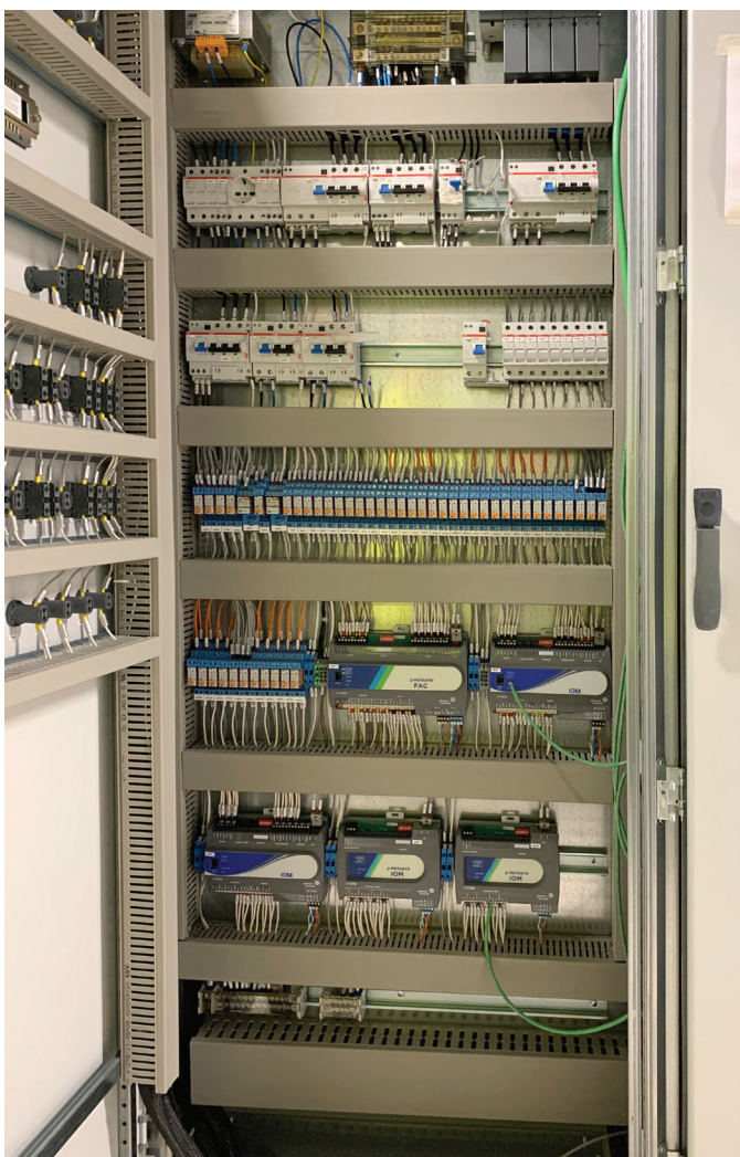
■ Sezione BMS Quadro elettrico di zona: Controller e moduli di acquisizione IN/OUT
