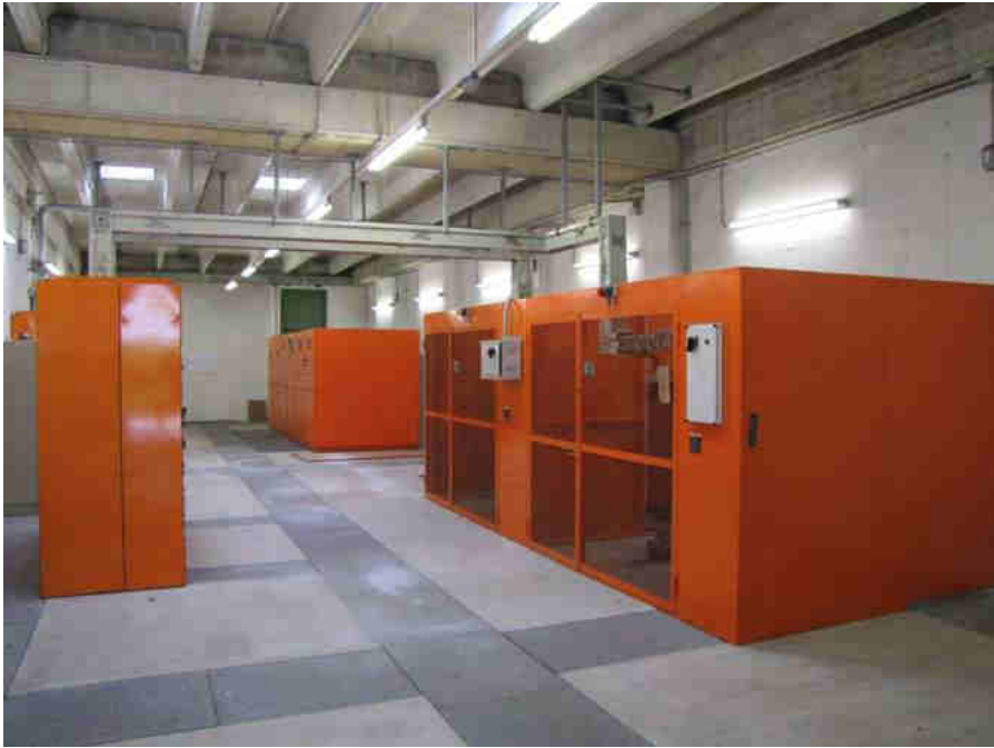
Cabina elettrica di trasformazione MT/BT Istituto Zooprofilattico Sperimentale delle Venezie
