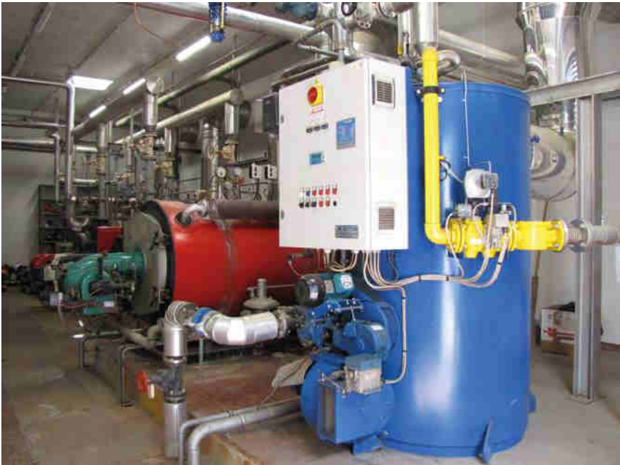
Centrale termica a servizio degli edifici universitari e di Veneto Agricoltura
