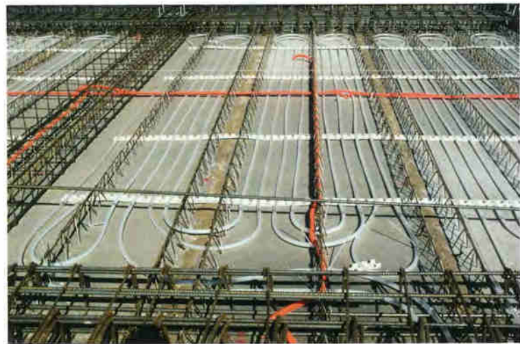
Pannelli radianti su predalle
